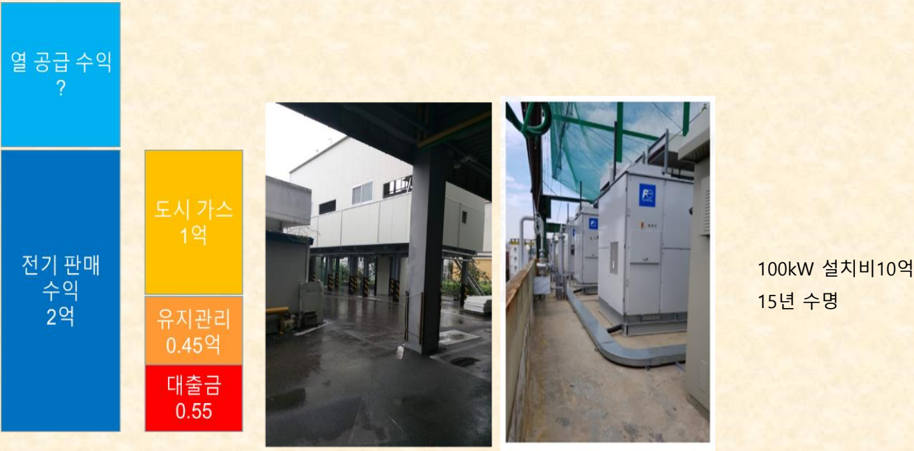
국내 설치 사례 200-300 kW (사우나장)
